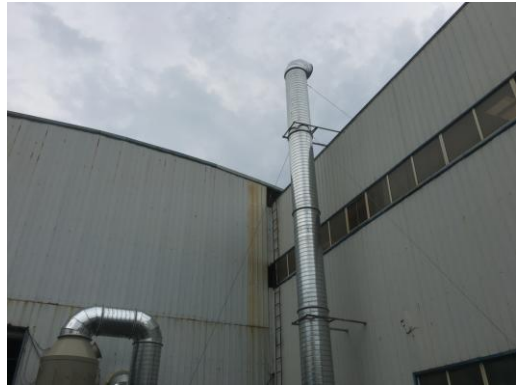
有机废气排气筒
